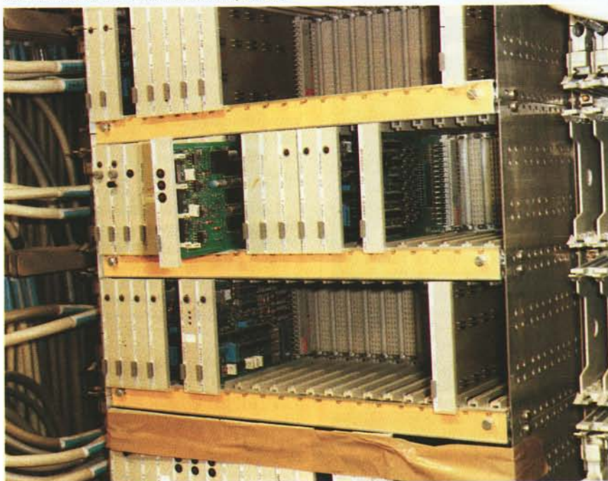
Módulos electrónicos de instrumentación y control.
