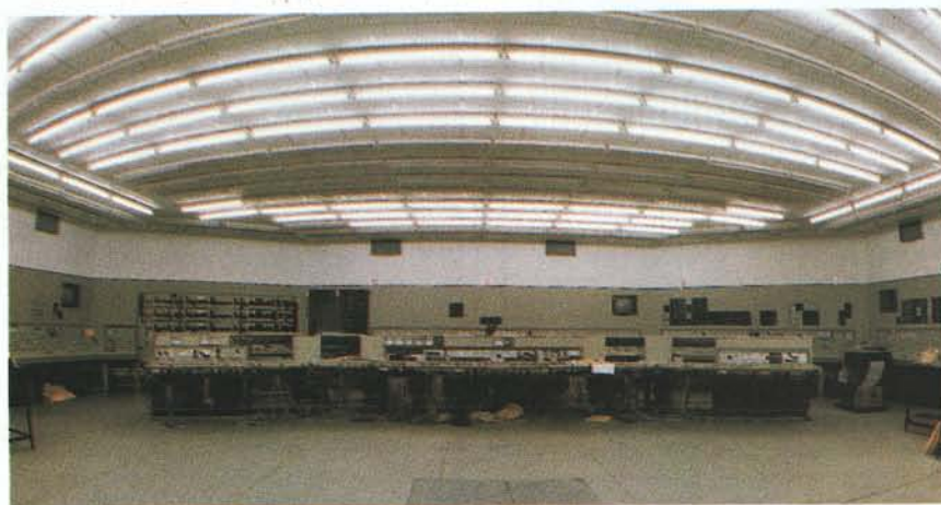
Vista general de los paneles en la sala de control en fase de cableado.
